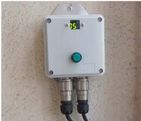
SISTEMA DE CONTROL DE LLAMADAS DE PLANTAS
